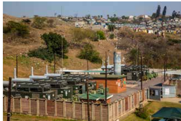
Figura 27: vista general de la central eléctrica de eThekweni, que recupera el metano formado por fermentación de los residuos y lo utiliza para producir electricidad. Durban, Sudáfrica. Crédito: Cyril le Tourneur d'Ison/AFD
